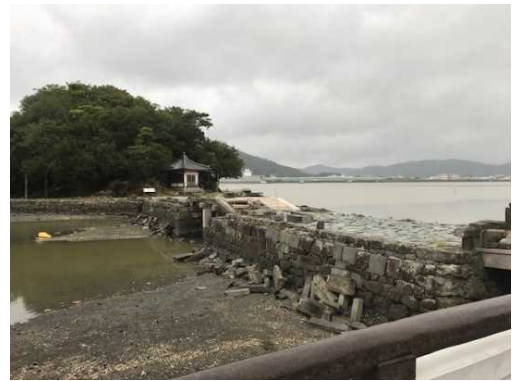
大きく破損した三断橋（和歌の浦）
