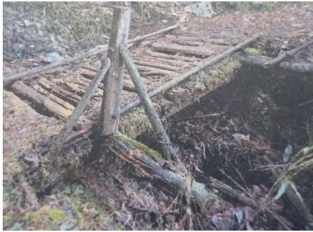
高野参詣道京大坂道不動坂の被災状況
