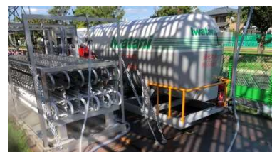
炬火台用水素燃焼システム
