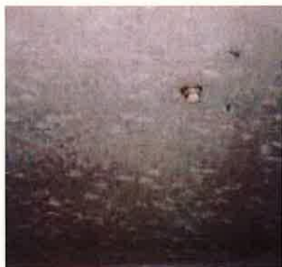
吸音・断熱材（機械室の壁・天井）
