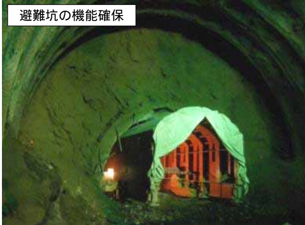
本線部避難坑防護プロテクター
