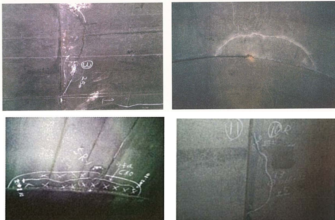
付写真-1.1 横断目地の天端付近に発生した半月状のひび割れの例
