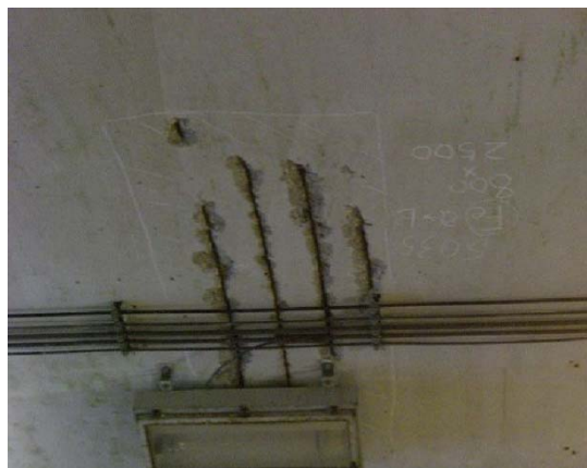
付写真-2.2 鋼材腐食の例
