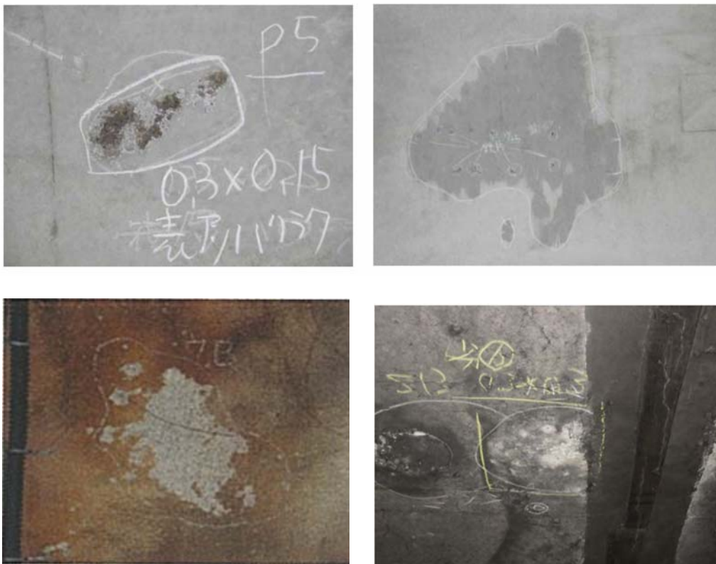
付写真-1.6 覆工コンクリートが変色している例 (うき・はく離を伴う)
