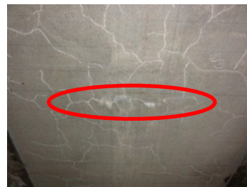
貫通ひびわれあり
