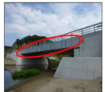
※地覆水切りが桁下まで打ち下ろされているため、横桁位置が確認できない。
