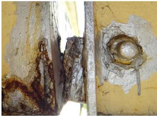
フックの溶接の状態 (接合部)
