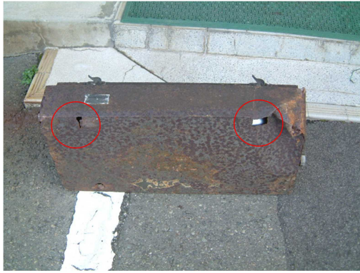
落下照明背面状況
