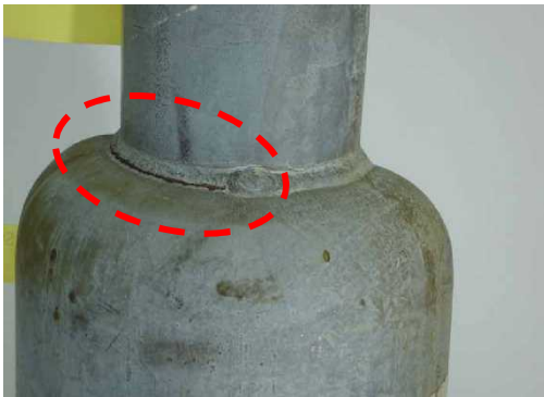
照明柱断面変化部の溶接に確認された亀裂 (歩道橋、15年経過)
