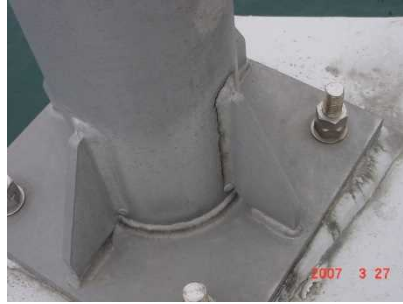
標識柱基部溶接部の亀裂
