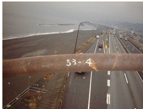
写真-解 8-11 支柱本体の腐食事例
