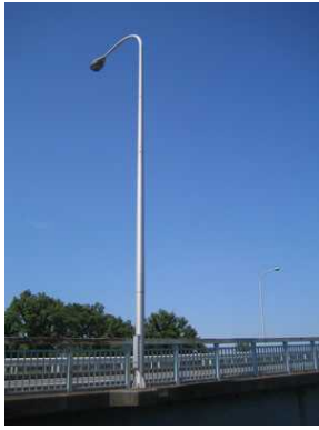
橋梁部に設置
