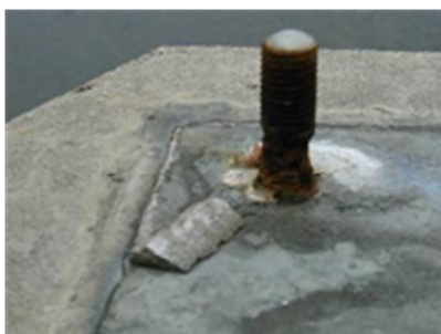
写真-解 6-2 転用部材のアンカーボルトの変状事例
