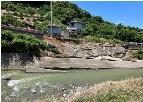
公共土木施設の被災の状況（海南市下津町中）
