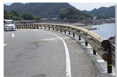
木製ガードレール
