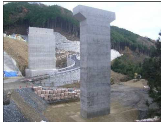
京奈和自動車道 紀北西道路(紀の川市) (株)小池組 橋脚 1基、橋台 2基 外
