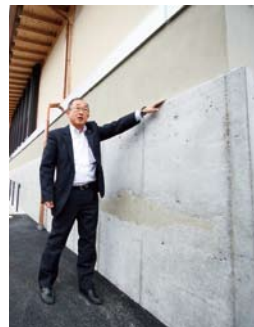
同様の被害を防ぐため基礎部分を1.5m高くしたと説明する館長。
